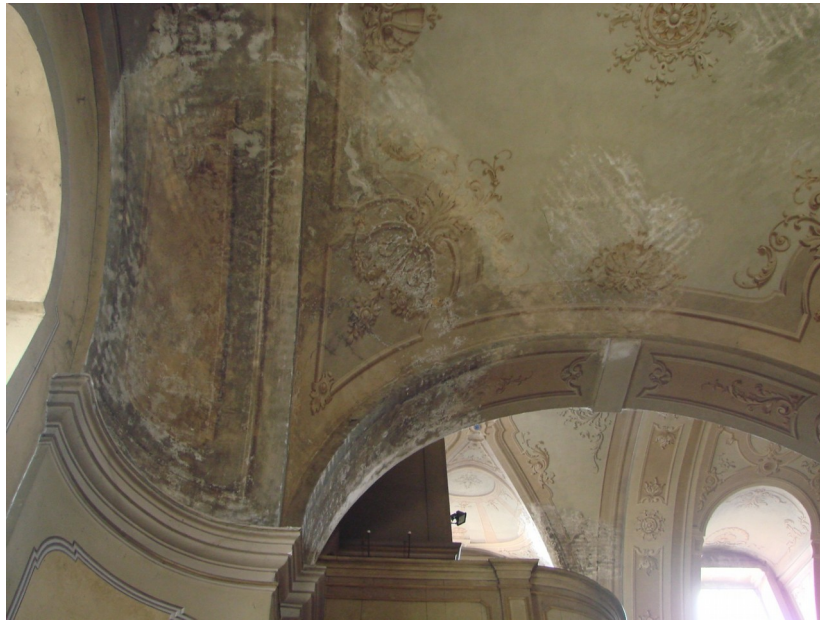
Infiltrazione d'acqua navata laterale destra
