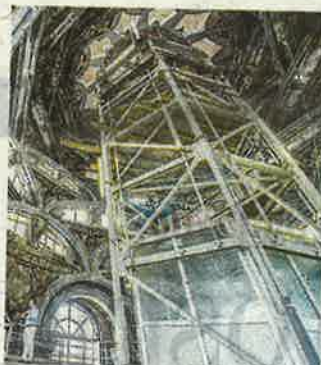
I lavori dopo l'incendio
